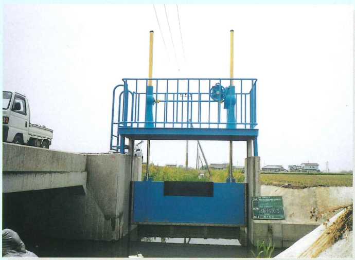
（ユニット式スライドゲート）
