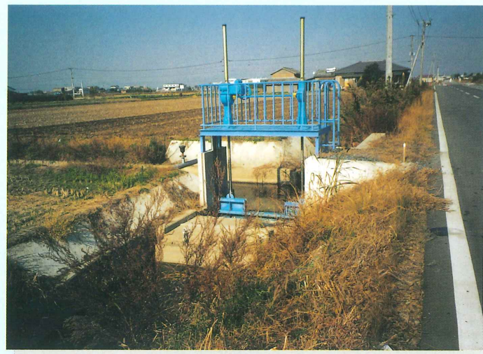
（ユニット式スライドゲート）
